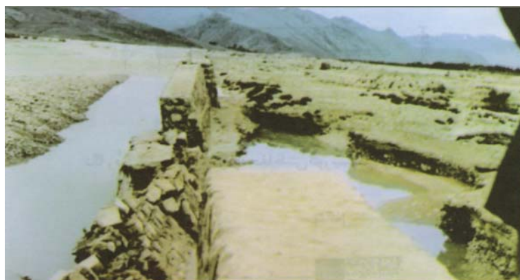
تصویر (۲-۳): دیوار اجرا شده بدون پیش بند، قبل و بعد از خرابی
