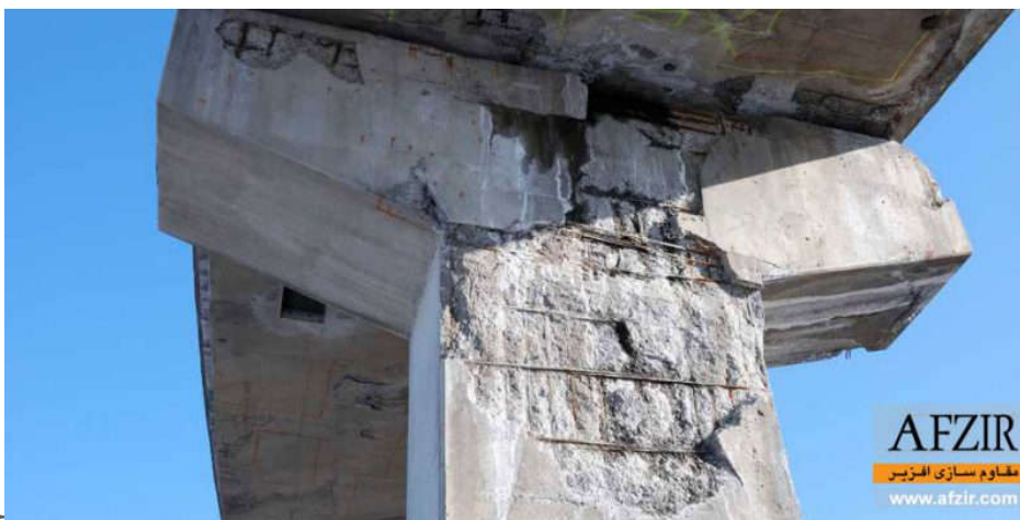
خوردگی پایه پل ها
